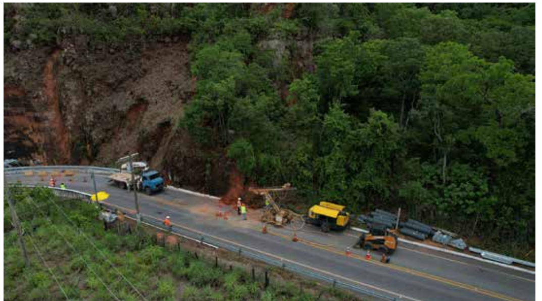
As obras de retaludamento consistem na retirada do maciço rochoso da curva do Portão do Inferno e a criação de taludes
