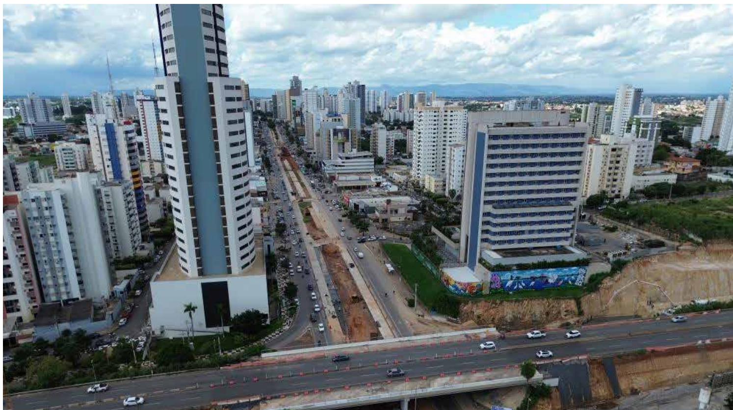
No viaduto sobre a Avenida do CPA, por exemplo, está sendo construída uma terceira faixa de rolamento
